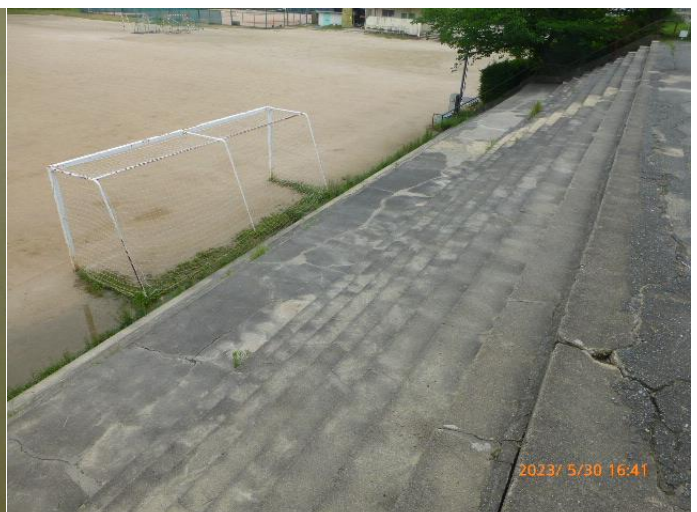
ひび割れが目立つ中央階段
