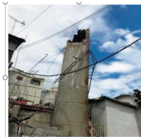
吹田市の被害状況 (吹田市消防局消防本部提供)
